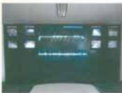
監視制御モニター
