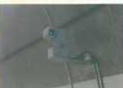
トンネル内監視カメラ
