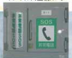
トンネル内非常電話
