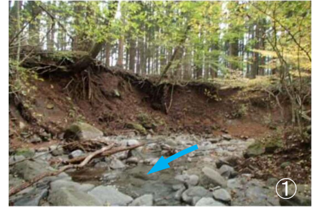
溪岸浸食状況
