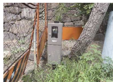
受水槽電源盤
