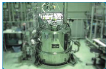
<バイオマスプラスチック製造設備>
