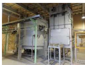
<Li-ion電池リサイクル設備>
