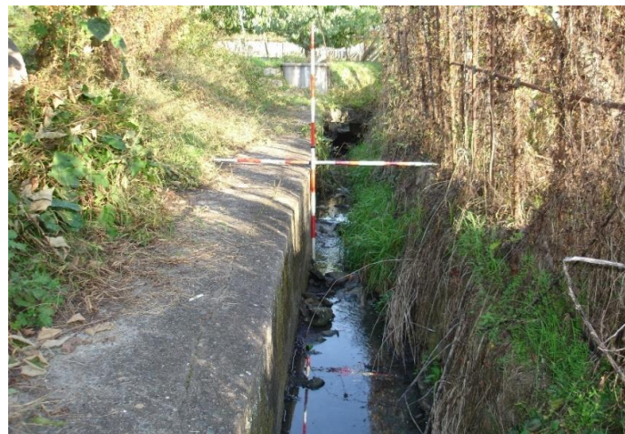
着工前 未整備のため溢水が多発していた。
