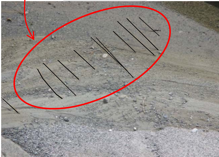
② 堰水叩き部分が長年の経年劣化により摩耗し鉄筋が露出している。
