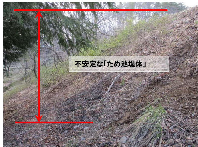
② 堤体の安定性が確保されておらず地震時に堤体が決壊する危険がある。
