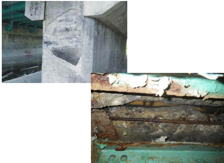
②現橋の損傷状況(上:橋脚の剥離鉄筋露出 下:床版の剥離鉄筋露出)
