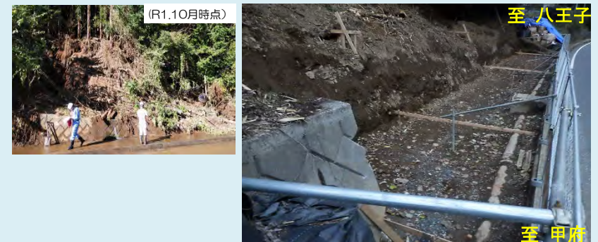
はちおうじみなみあさかわまち ② 八王子市南浅川町 重力式擁壁による本復旧施工中
