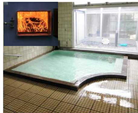
木質バイオマス利用温泉施設
