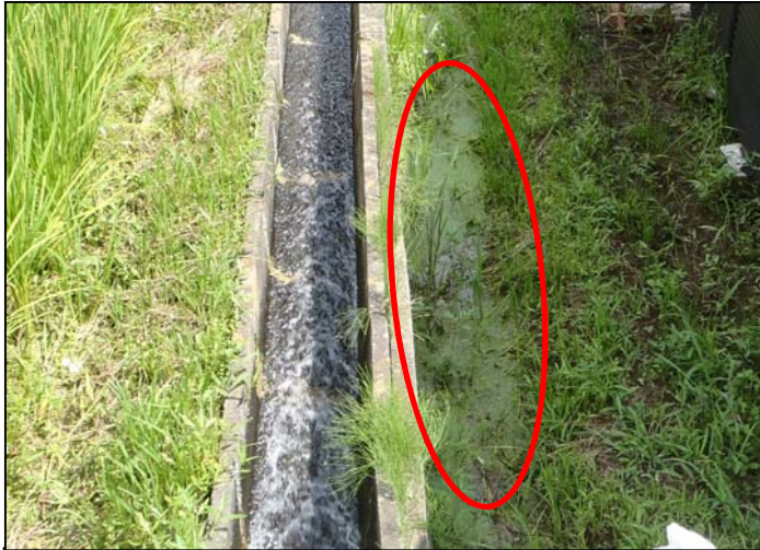
用排水路に亀裂が入り漏水している
