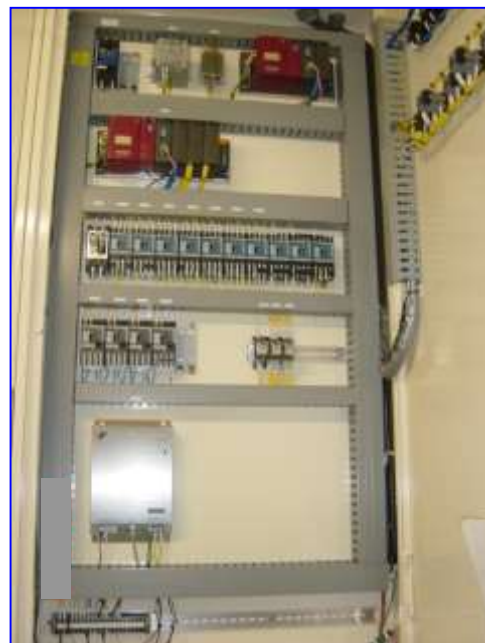
空調・照明制御盤
