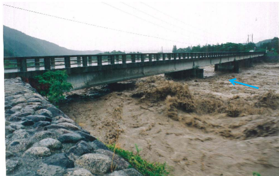
【写真④】 洪水の状況 (平成2年8月 台風11号)
