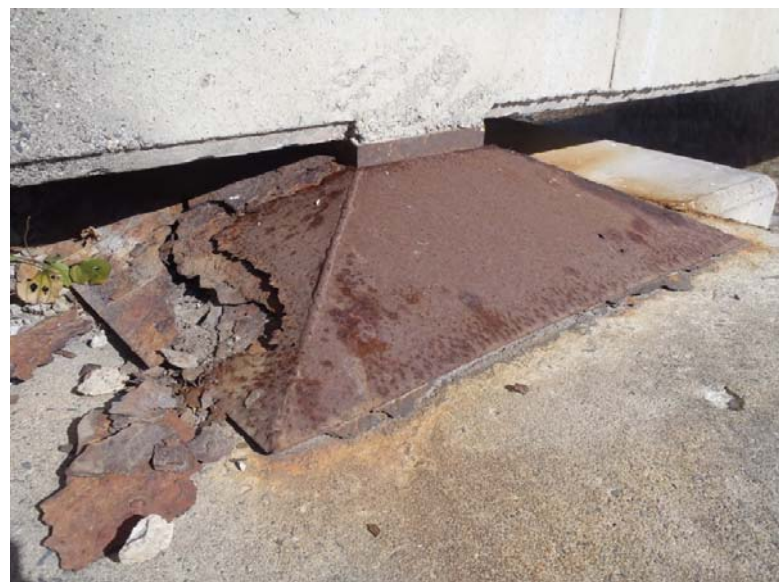
【写真②】 現橋の劣化状況 (鋼製支承がうろこ状腐食により損傷)
