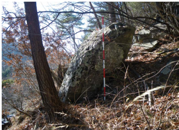
【写真①】 現道法面上の状況（防災カルテ要対策箇所：大塊円礫の転石）
