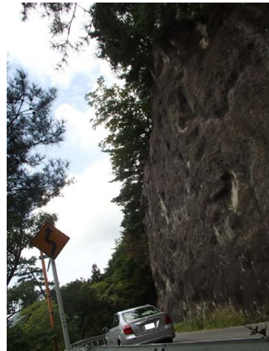
【写真②】 現道法面の状況（落石発生源）
