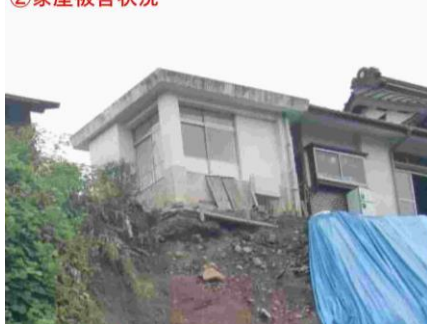
②家屋被害状況
