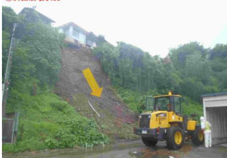
①斜面崩壊状況
