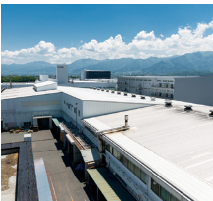
工場の屋根にハイタフシートを設置し 建物内の温度上昇を抑えている
