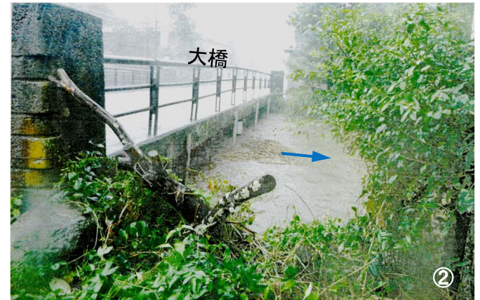
溢水状況 H23.9.21 (台風15号)
