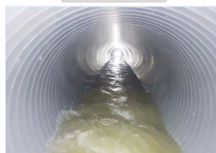
機能が回復し、耐久性が向上した下水道管路
