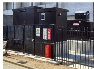
非常用発電設備（小瀬スポーツ公園）
