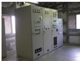
大門ダム（堰堤改良） ダム管理用制御処理設備改良
