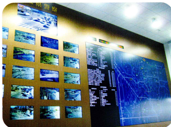
交通管制センター
