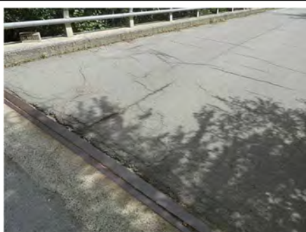
写真 1-4 舗装 (舗装のひびわれ)
