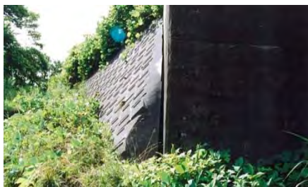
写真 2-1 橋台取付部（橋台と擁壁との隙間）
