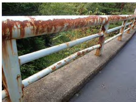
写真 1-1 高欄 (横桟損傷)
