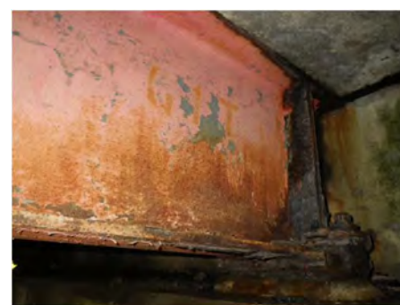
写真 1-5 主桁 (腐食・防食機能の劣化)
