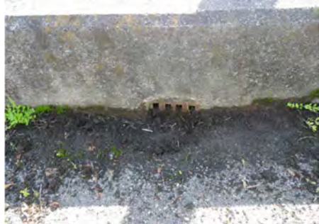
写真 1-3 排水ます (土砂詰まり)
