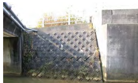
写真 2-2 橋台取付部（擁壁の目地開き）
