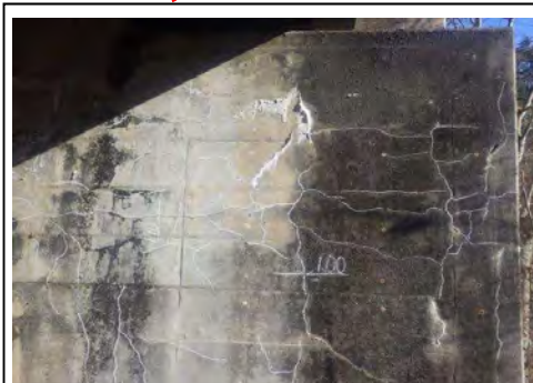
写真 1-7 下部工 (ひびわれ、漏水・遊離石灰)
