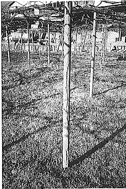
写真-3 クラックが入ったコンクリート製束杭
