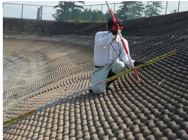
② 経年変化により、堤体法面に孕み出しが生じている。
