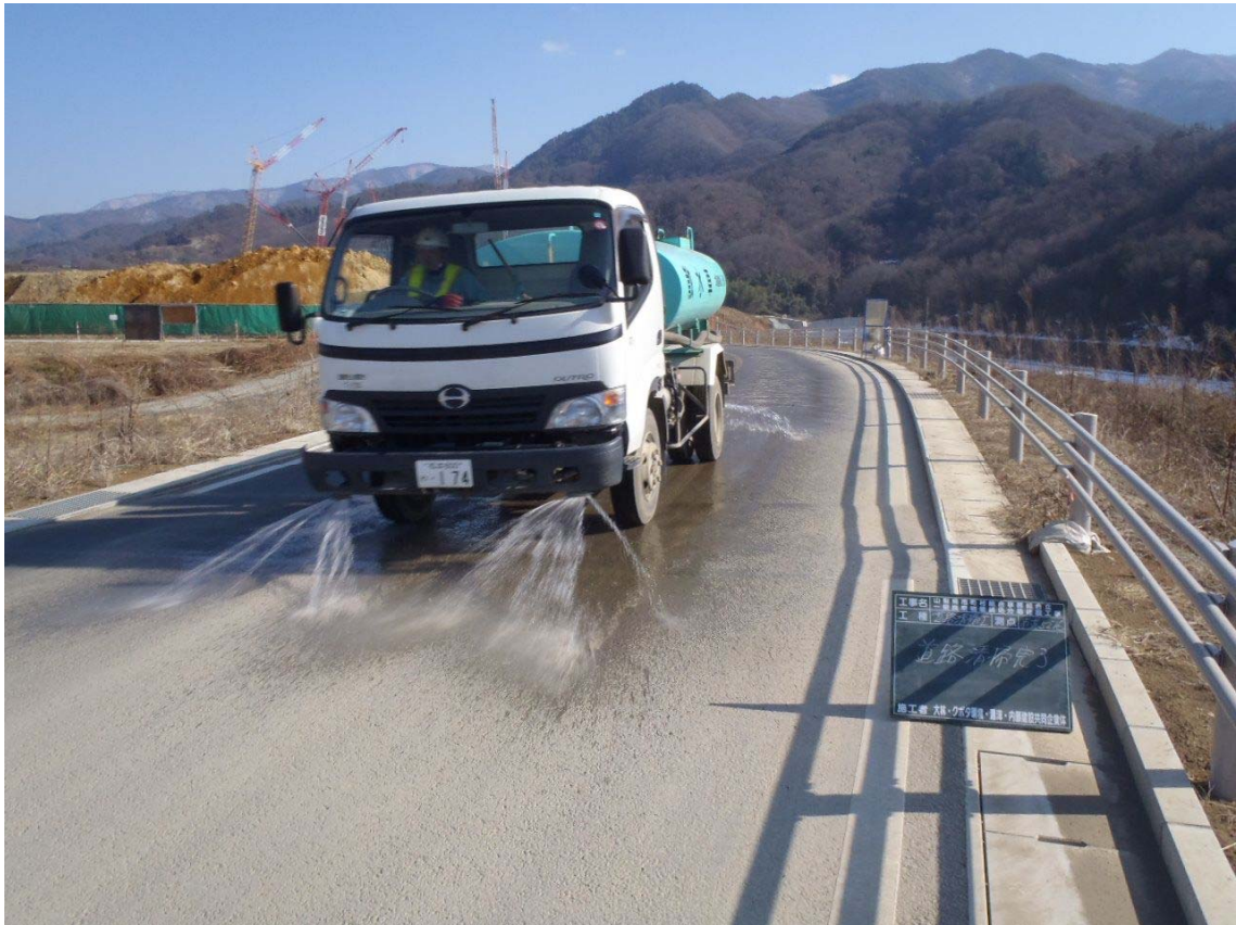
路面散水状況
