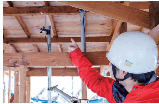
建物内部にセンサーを取り付けて梁や柱などへの影響を調べている
