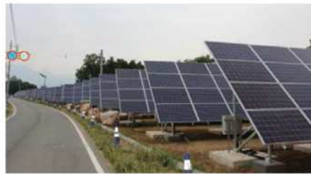
生活道路の間近に大規模太陽光発電設備が設置
