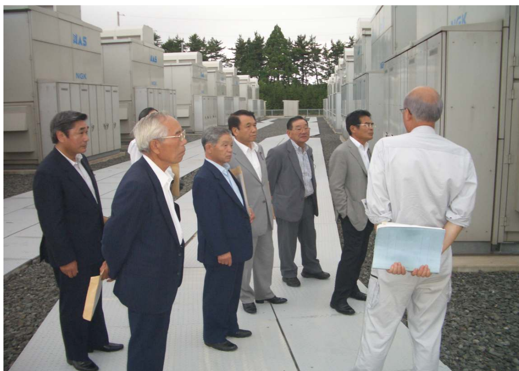
※六ヶ所村二又風力発電所でのNAS電池視察の様子
