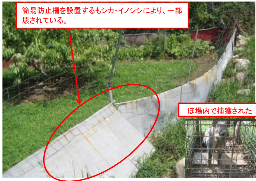
②獣害(シカ、イノシシ)による被害の状況
