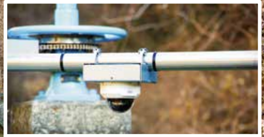
カメラの設置によりスマートフォンで水位の確認が可能
