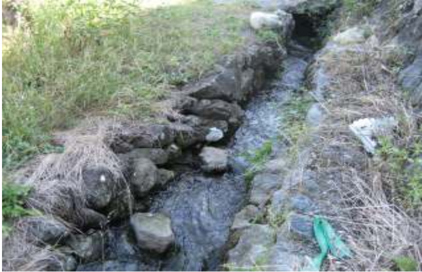
①老朽化により石積みが崩落した水路
