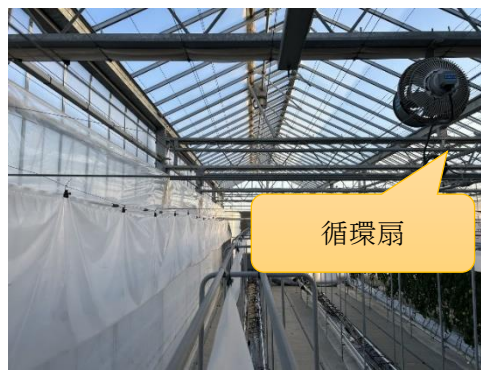
図 I-10 設置した循環扇の様子
