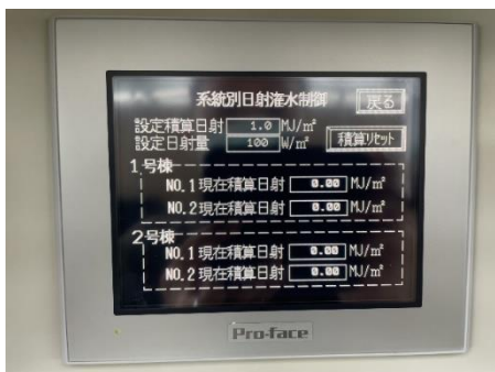
図 I-3 養液システム制御盤
