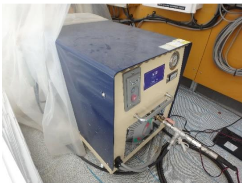
図 I-7 細霧冷房装置
