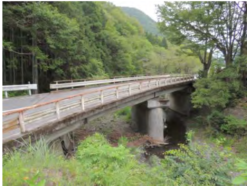
②現道 老朽化した橋梁(駿道橋)
