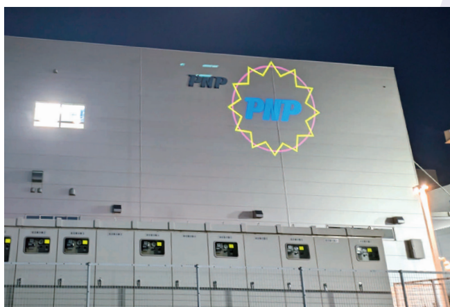
夜になると社屋のPNPのロゴの周りを星型に彩るプロジェクター投影。この動力源は燃料電池発電機だ(同社提供)
