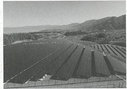
米倉山太陽光発電所 (一般家庭3,400軒分の年間使用電力量に相当する約1200万kWhの電力を一年間に生み出しています)
