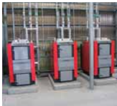
早川町ヴィラ雨畑薪ボイラー
