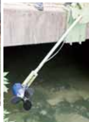
水力発電のきっかけになった用水路を使った簡易水力発電
