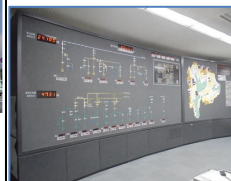
総合監視盤 更新
