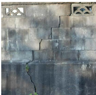
【大きなひび割れ】
