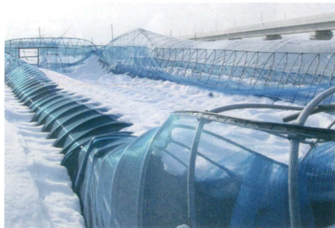
パイプハウス屋根の陥没
