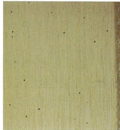
被害を受けた木材（ラワン材） （多数の孔があいている）
