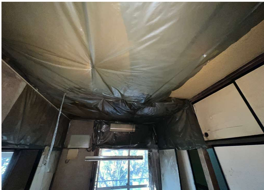
㊦和室2天井水漏れ防止シートあり
