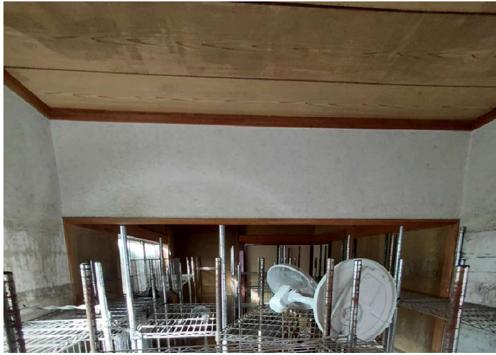
④天井や壁にシミあり
