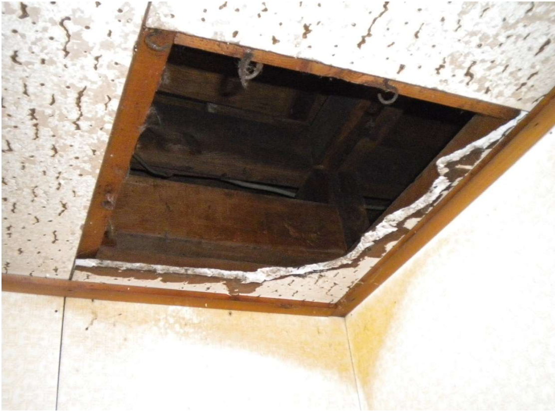
⑥玄関口左 天井部分に穴あり
