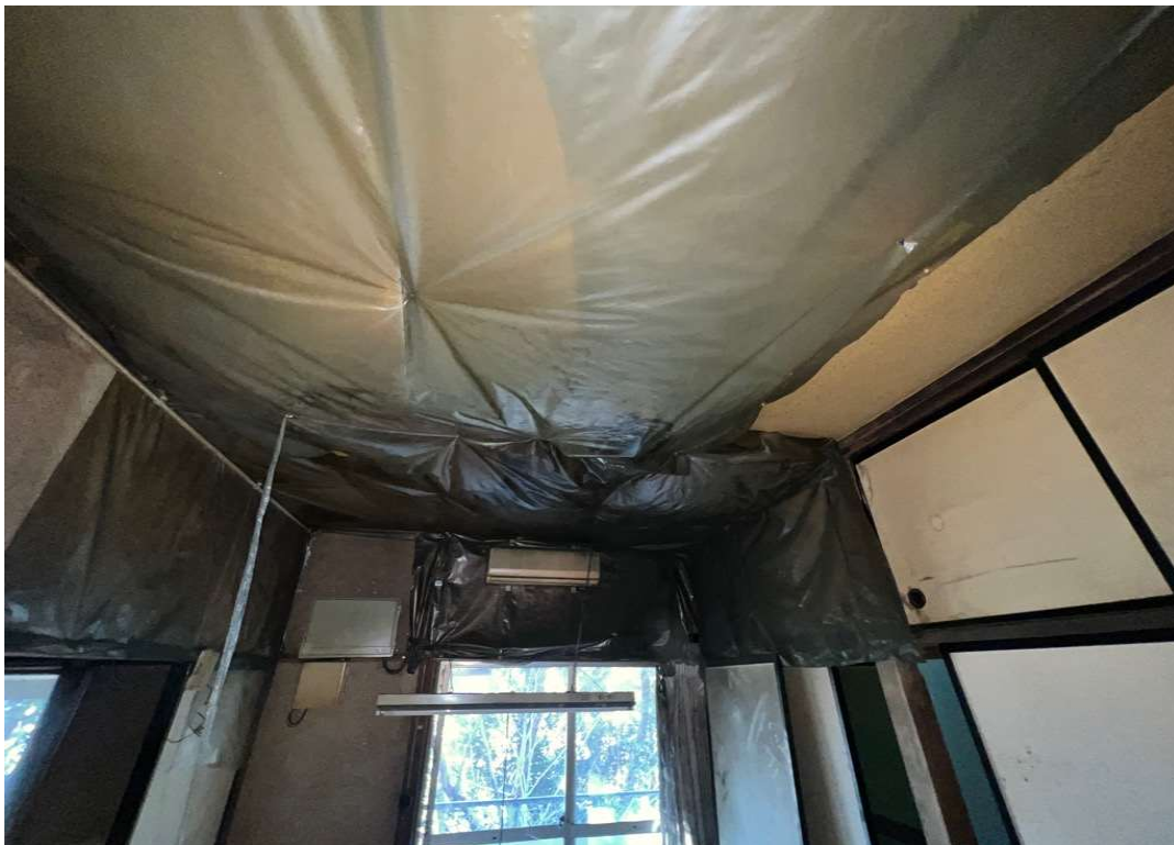
㊸和室2天井水漏れ防止シートあり
