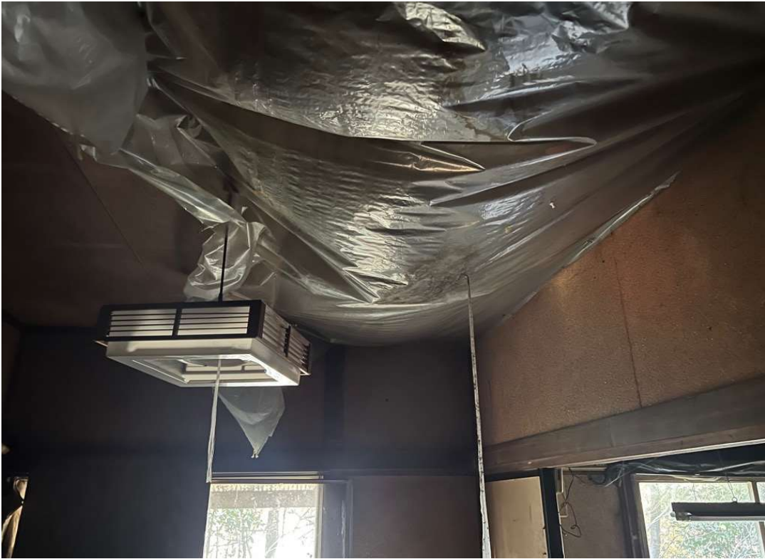
②和室①天井に水漏れ防止シート有
