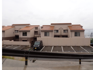
写真10 広島市安佐南区の県営住宅のRC塀
