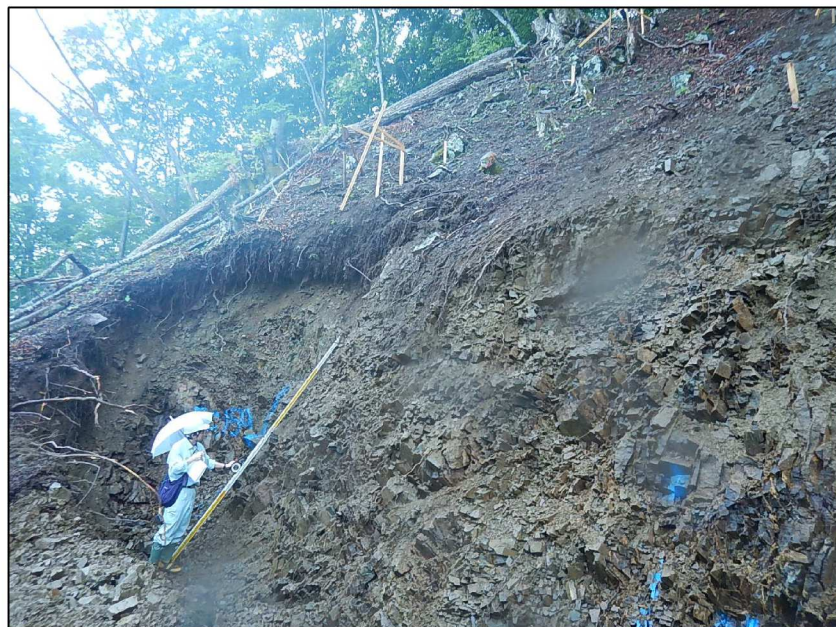
⑦ 切土法面岩盤の強風化状況
