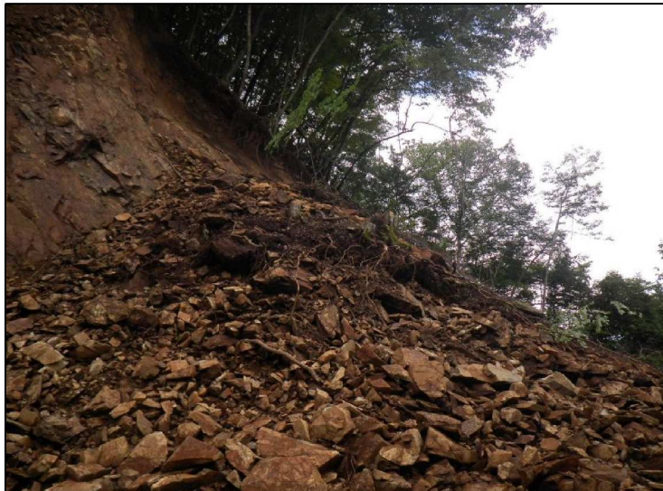
法面崩落の状況
