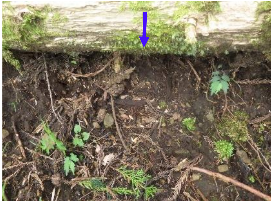
移植地①の土壌侵食の状況 (青矢印は侵食方向)
