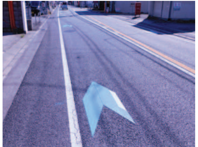
■ 自転車通行空間 矢羽根型路面標示
