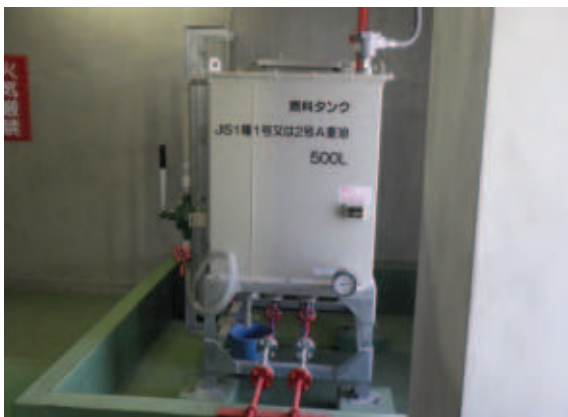
■ 下水道ポンプ場の自家発電設備
