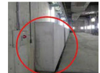
■ 下水道処理場の耐震化
