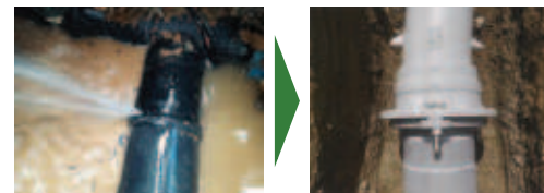
■ 耐震化された水道管
